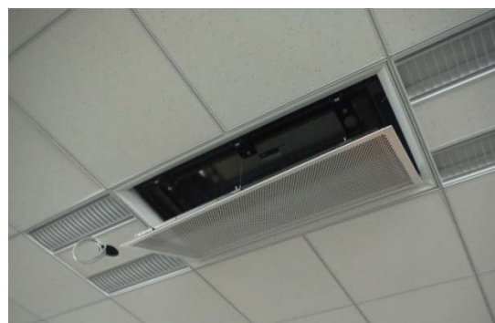
写真3 チルドビーム本体(フェースの開閉状況)
